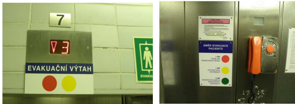
Označení evakuačních výtahů
