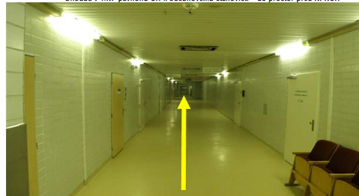
Chodba v 1.NP pavilonu CH k odsunovému stanovišti – do prostor před KPRCH
